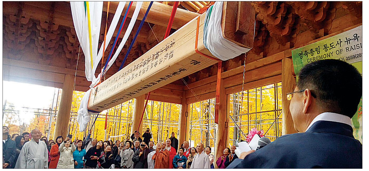
이광복 도편수의 지휘아래 7명의 대목과 스님, 신도들이 직접 참여해 대들보를 올리고 있다. 사진제공=뉴욕 원각사
