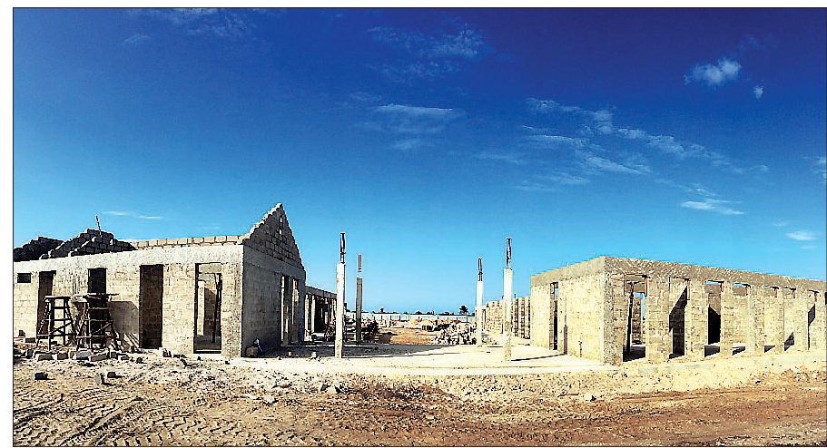
조계종이 탄자니아에 건립 중인 보리가람 농업기술고등학교 본관, 행정동 및 도서관의 공사 진행 모습. 현재까지 50%가량이 진행됐으며, 내년 4월 완공될 예정이다.
