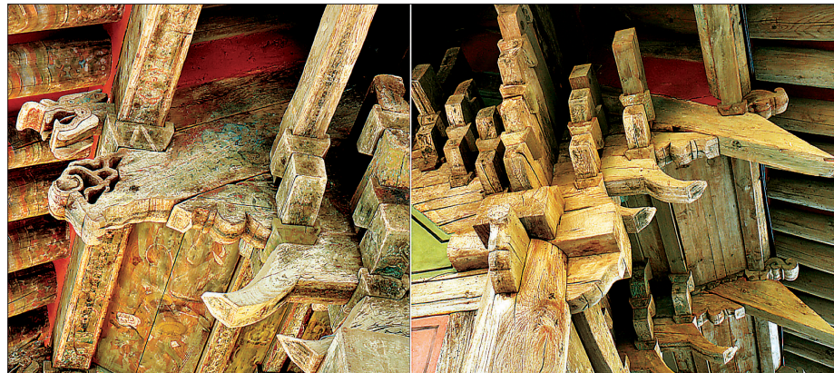
극락전 공포와 지붕 사이의 하양구조. 국내에서 하양장치를 갖춘 건축은 완주 화암사 극락전이 유일하다. 왼쪽의 용두 하양은 앞면장치이고, 오른쪽의 빗변 하양은 뒷면장치다.
