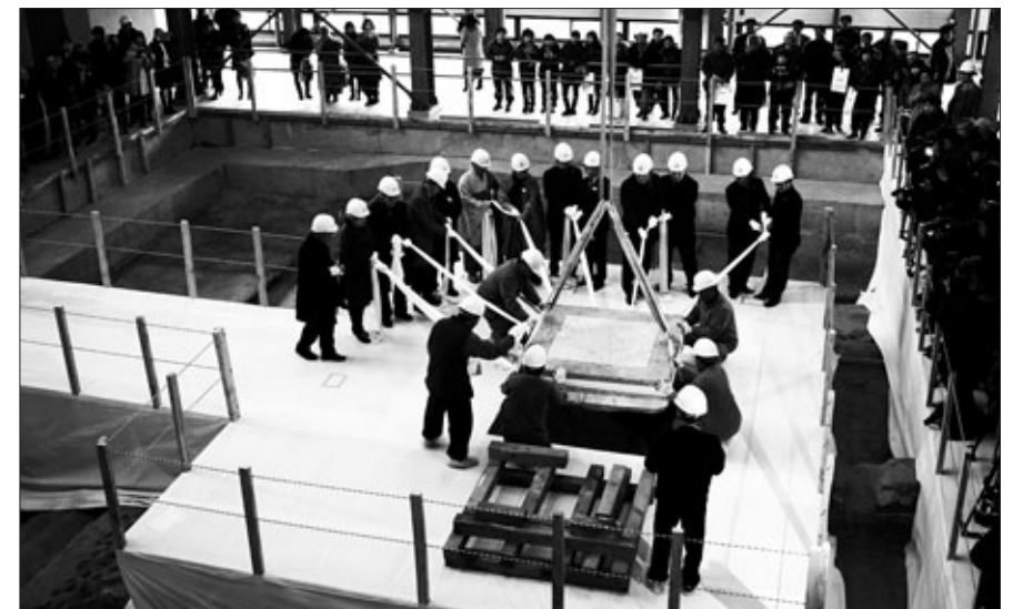
현존하는 석탑 가운데 가장 오래되고 규모도 큰 미륵사지 석탑이 11월 26일 11년간의 해체 작업을 마무리하고 본격적인 복원 작업에 들어갔다. 복원 착수식에서 육중한 무게의 심초석을 제자리에 맞추는 장면.
