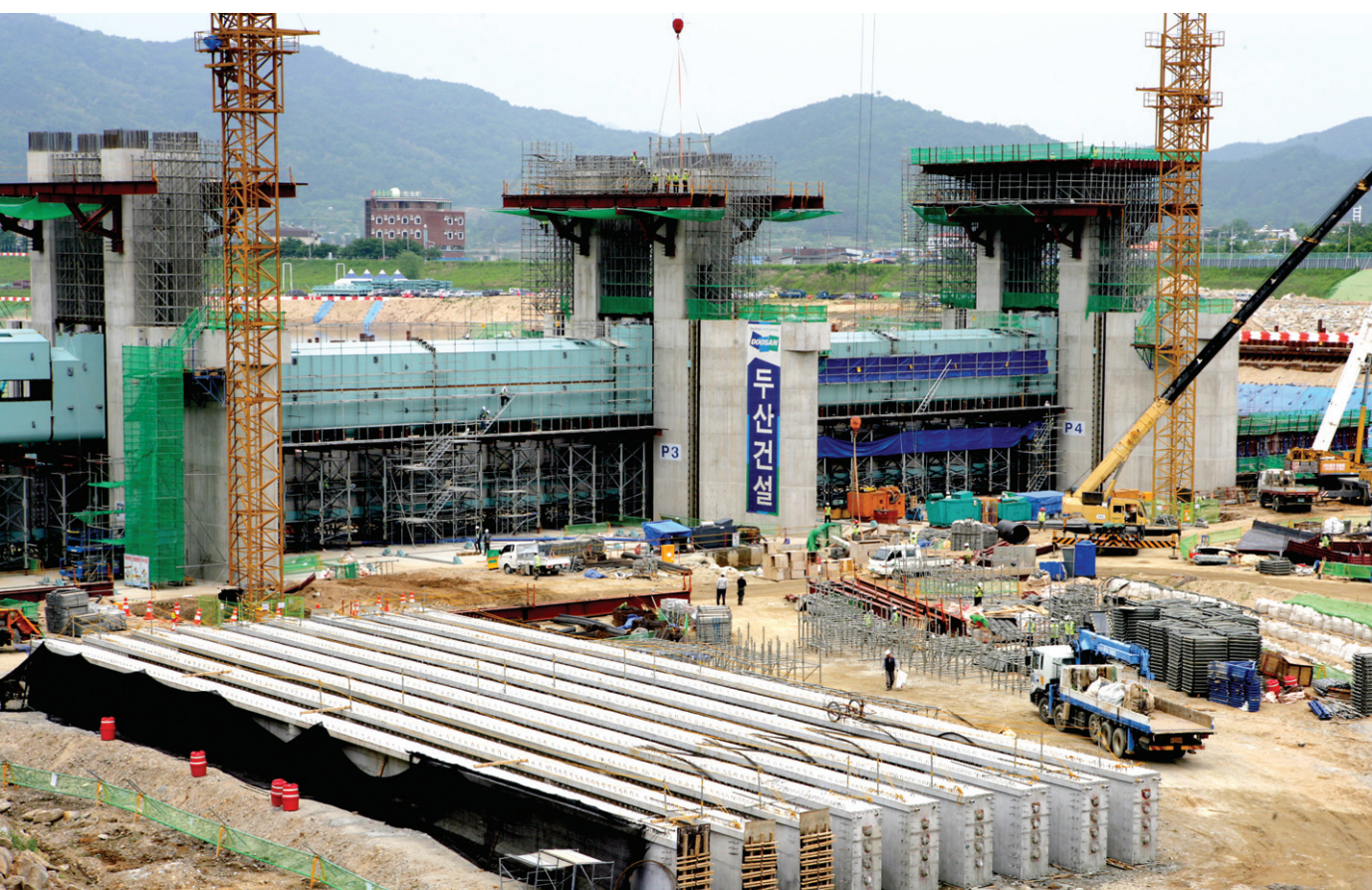
낙동강 낙단보 공사 모습. 유속 변화로 낙동강 보들의 균열이 속속 발견되고 있다. 인간이 자연을 제어하려고 한 오만함의 결과다. 이 때문에 국민들은 2조원의 혈세를 매년 강바닥에 쏟아부어야 한다.
