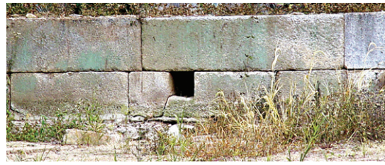
회암사지 장대석 석단에 난 물구멍
