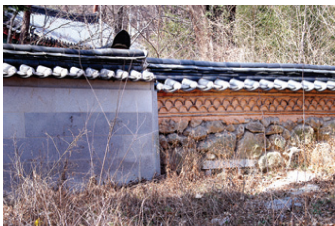
기존의 담장과 어울리지 않는 화강석 판석을 사용해 담장을 연결한 경우
