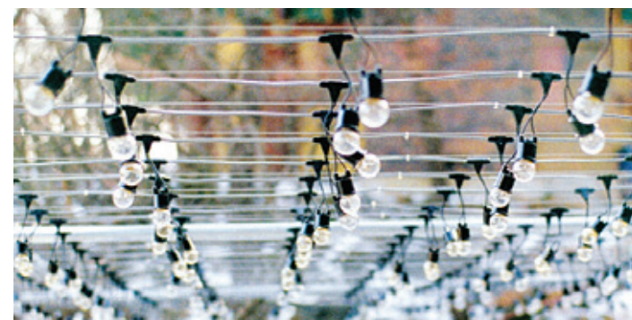
외부에 시공된 전선(케이블)
