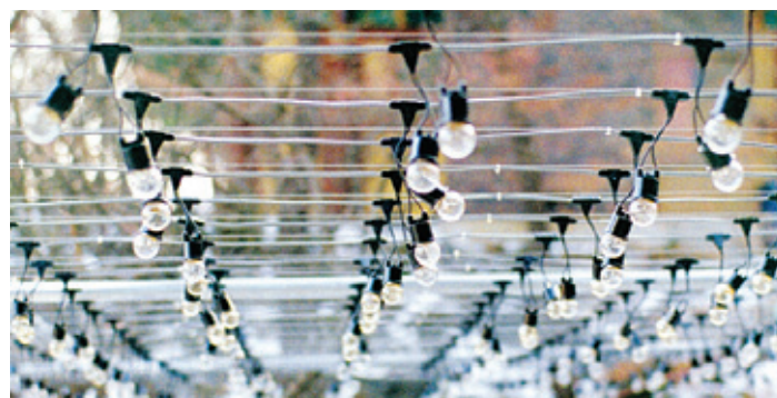
외부에 시공된 전선(케이블)
