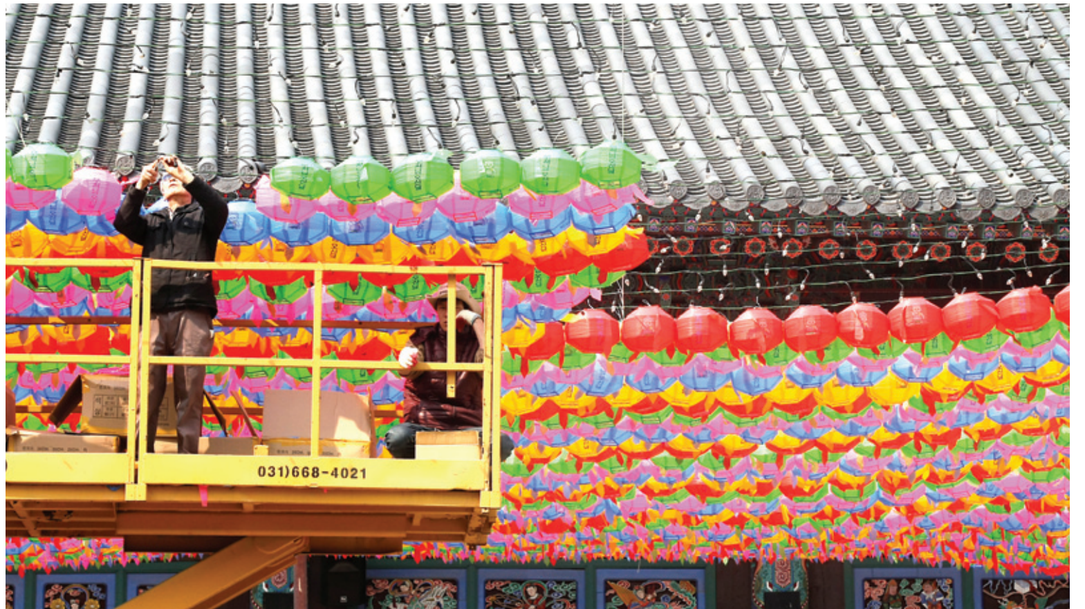
한뫼 한뫼 장인의 손길로 조계사에서는 부처님 오신날을 맞아 연등을 설치하는 작업이 한창이다. 3월 31일 작업 차량 위에서 연등을 설치하는 기술자의 손길이 분주하다. 유난히도 쌀쌀한 불교계와 정부의 관계가 저 등이 밝히는 빛과 온기로 아름답게 회향되길 바라며, 무엇보다 부처님 글=박기범 기자 사진=박재원 기자
