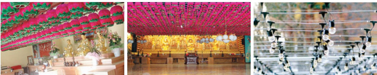
연등 자동 승강장치 _ 대구 여래사 연등 자동 승강장치 _ 서울 화계사 외부에 시공된 전선케이블
