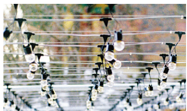
외부에 시공된 전선케이블
