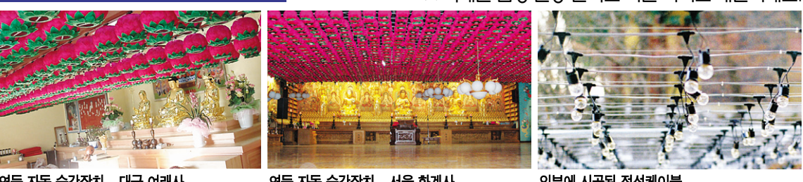
연등 자동 승강장치 _ 대구 여래사 연등 자동 승강장치 _ 서울 화계사 외부에 시공된 전선케이ابل
