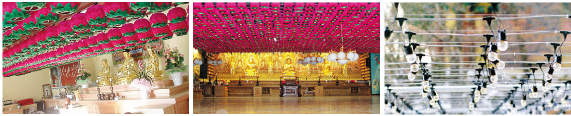
연등 자동 승강장치 _ 대구 여객사 연등 자동 승강장치 _ 서울 화계사 외부에 시공된 전선케이블
