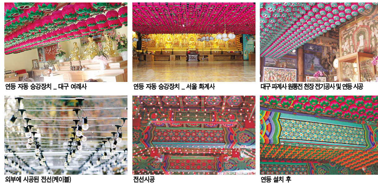
외부에 시공된 전선(케이블)
