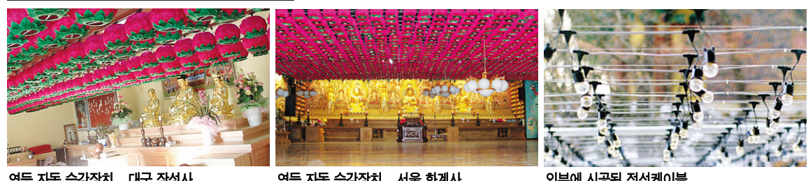
연등 자동 승강장치 _ 대구 정선사 연등 자동 승강장치 _ 서울 화계사 외부에 시공된 전선케이블
