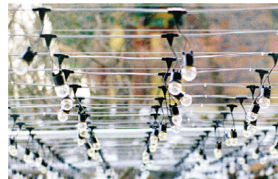
외부에 시공된 전선(케이블)
