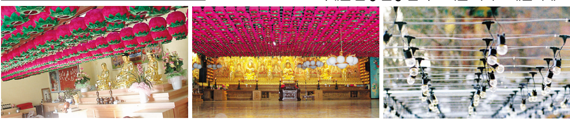
연등 자동 승강장치 _ 대구 정선사 연등 자동 승강장치 _ 서울 화계사 외부에 시공된 전선케이블
