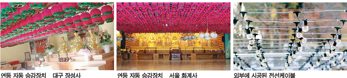
연등 저등 승강장치 _ 대구 장성사 연등 저등 승강장치 _ 서울 화계사 외부에 시공된 전선케이블
