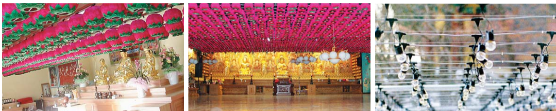
연등 자동 승강장치 _ 대구 정성사
