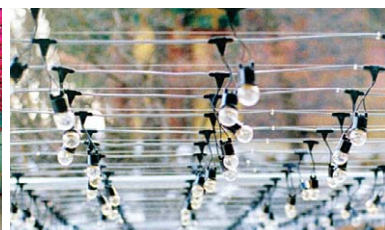
외부에 시공된 전선케이블
