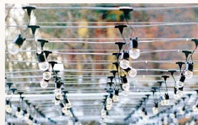
외부에 시공된 전선(케이블)
