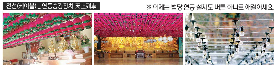
연등 자동 승강장치 - 대구 정경사, 연등 자동 승강장치 - 서울 화계사, 외부에 시공된 전선케이블
