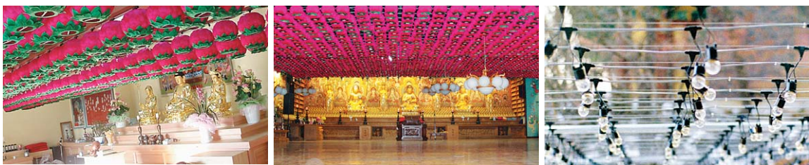
연등 지등 승강장치 _ 대구 정경사 연등 지등 승강장치 _ 서울 화계사 외부에 시공된 전선케이블
