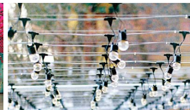
외부에 시공된 전선케이블
