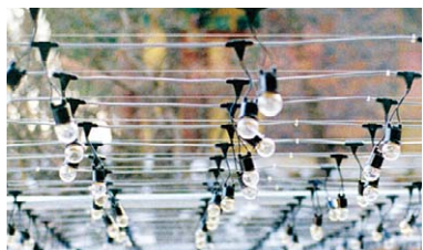
위부여 시공된 전선케이블
