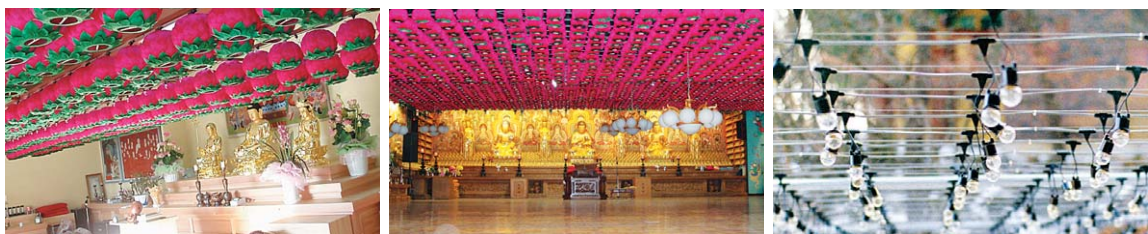
연등 자동 승강장치 _ 대구 장성사 연등 자동 승강장치 _ 서울 화계사 외부에 시공된 전선케이블
