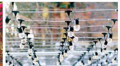
외부에 시공된 전선케이블
