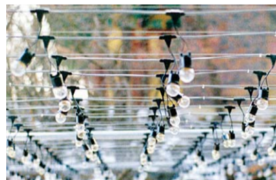
▷외부에 시공된 전선(케이블)
