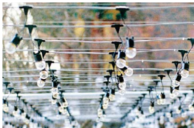
외부에 시공된 전선(케이בל)
