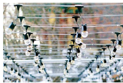
▷외부에 시공된 전선(케이בל)
