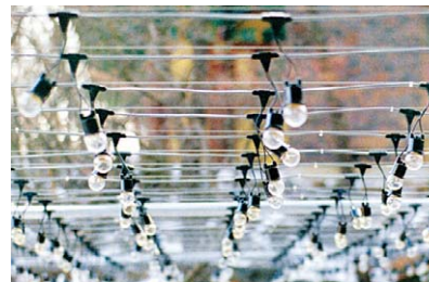
▷외부에 시공된 전선(케이בל)
