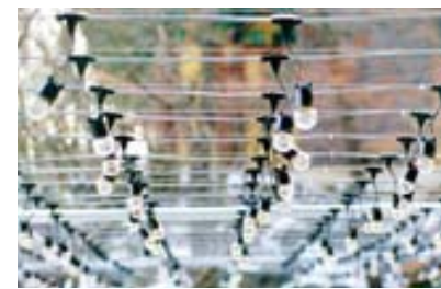
▷외부에 시공된 전선(케이블)
