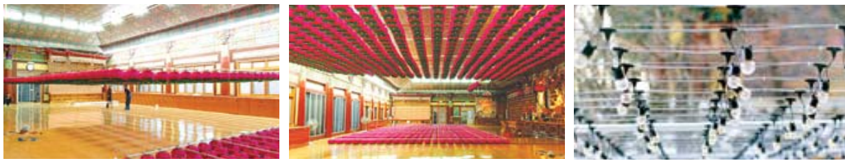
자등 승강 장치(등표 조정 작업) 연등 자동 승강장치 작동 외부에 시공된 전선케이블 찬덕연등에서는 KS케이블을 사용하여 가장 안전하게 전문 기술인에 의해 직접 감독 시공합니다.
