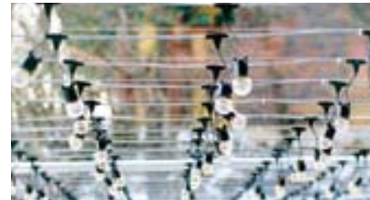
외부에 시공된 전선케이블
