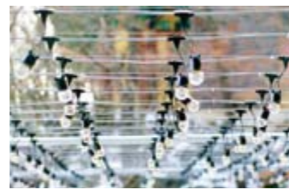
▷ 외부에 시공된 전선케이블
