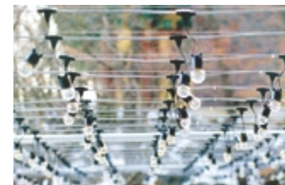
▷외부에 시공된 전선케이블
