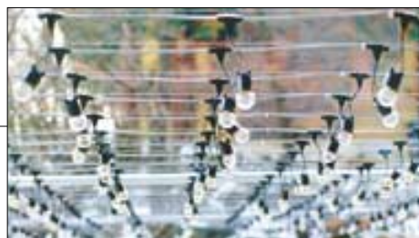
외부에 시공된 전선케이블
