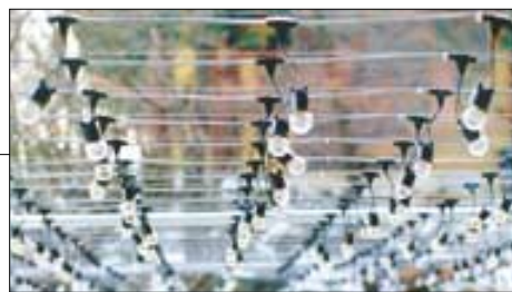
외부에 시공된 전선케이블
