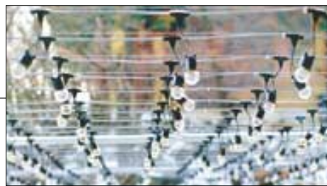
외부에 시공된 전선케이블
