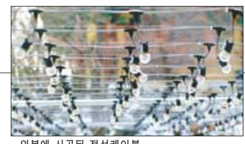
외부에 시공된 전선케이블
