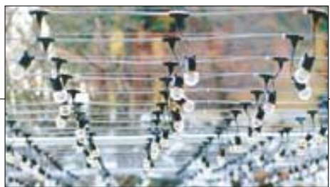
외부에 시공된 전선케이블
