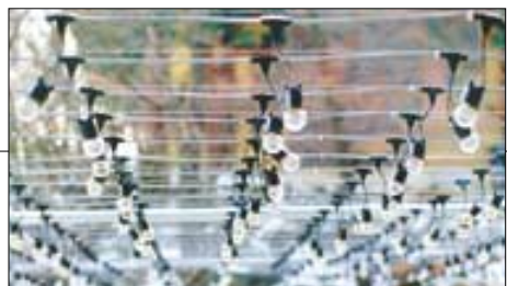
외부에 시공된 전선케이블
