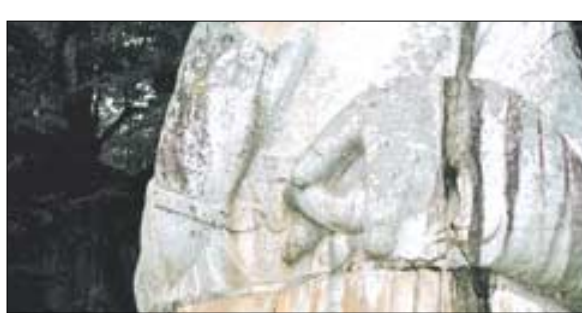
육개부가 이끼류의 서식처가 되고 경계 변해버린 국보 정림사지5층석탑(위)과 관촉사 은진미륵 손부분에 나타난 균열과 백화현상.
