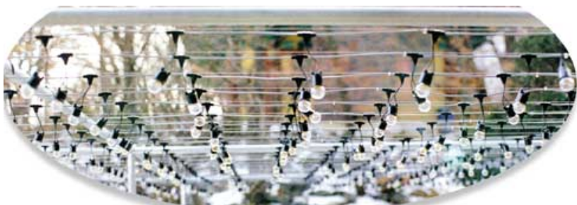
* 시공된 연등용 전선 케이블 *
