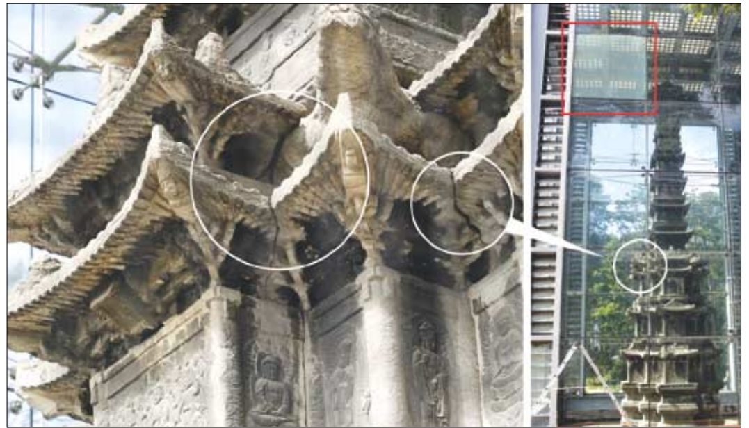
원각사지 10층석탑 · 보호각 균열
