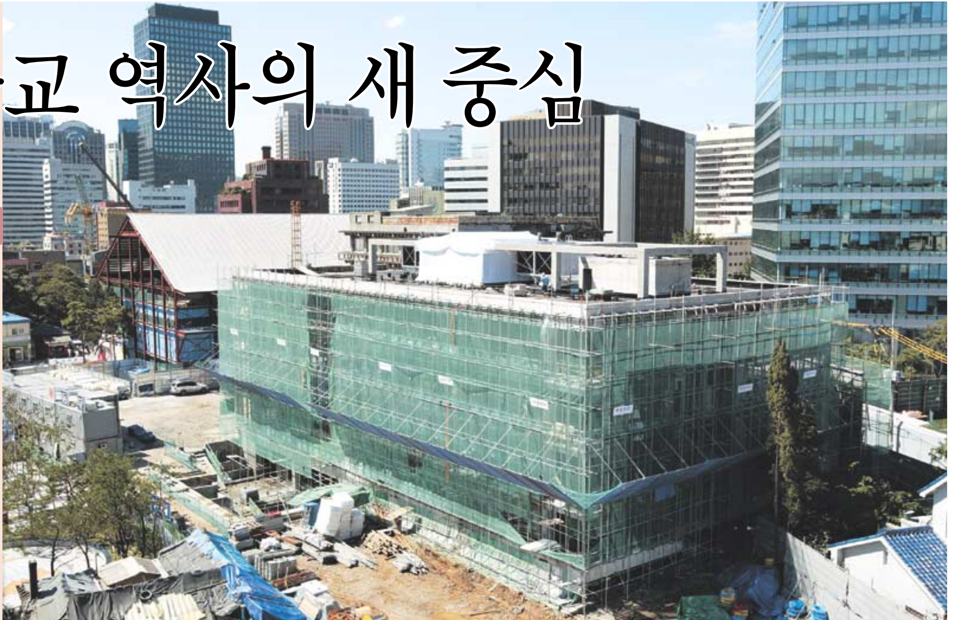
◀한국불교역사문화기념관이 8월 29일 상량식을 갖고 그 위용을 드러냈다. 현재의 총무원 청사는 본 건물이 완공된 후 헐릴 예정이다. 사진=박재원 기자
