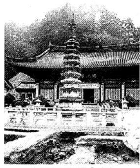
△월정사팔각구층석탑 팔각구층석탑은 1층 북쪽 몸체(탑신) 부분의 균열 현상과 2층, 5층 몸체의 균열을 육안으로도 확인할 수 있는 상태다. 또한 3층 몸체의 지붕돌(목개
