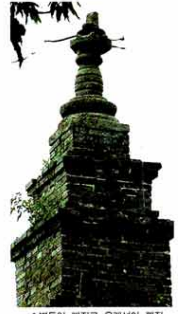
◊벽돌이 빠지고 옥개석이 깨진 여주 신록사 다층전탑.
