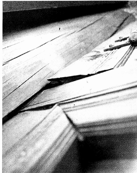
◇보물 1292호 철조노사나불이 안치된 심화사 적광전 건물에 발파진동에 따른 뒤돌림에 의한 균열로 붕괴위험에 직면해 있다.
